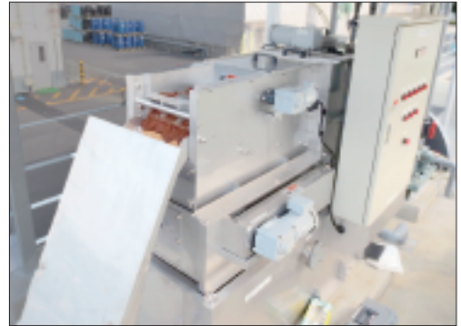
SPATON脱水機全体
